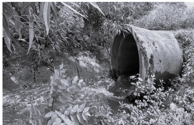
Рис. 1. Каналізована ділянка русла річки Зубра в яку скидаються неочищені каналізовані стоки з житлового масиву Сихів. Фото авторів
