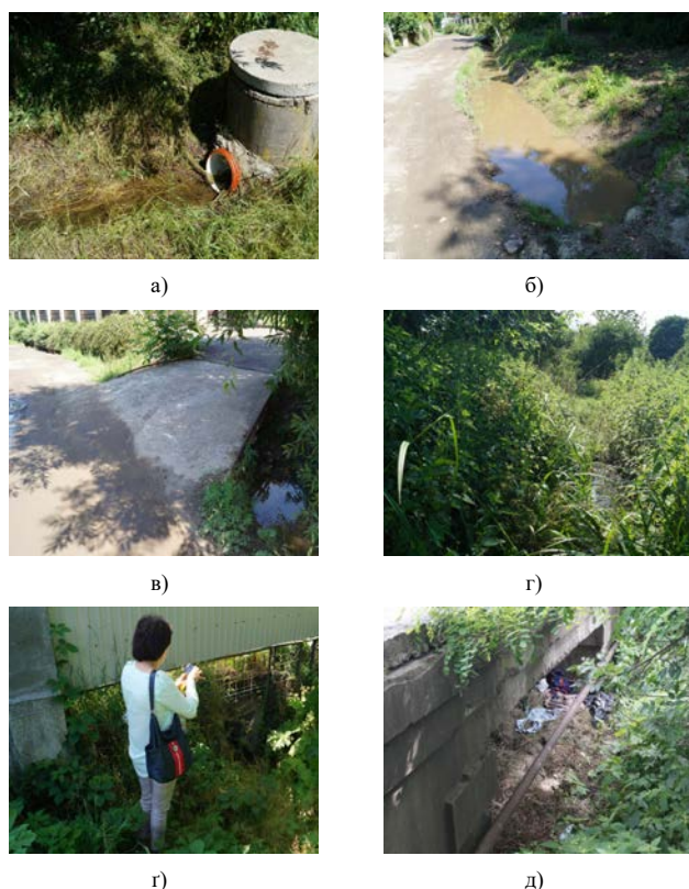
Рис. 3. Долина Збоївського потоку: а) один із колекторних колодязів; б) фрагмент залишкової канами; в) бетонний місток над потоком; г) заросла частина русла; г) рештки старої дренажної системи; д) міст у районі Галицького перехрестя (фото авторів)
